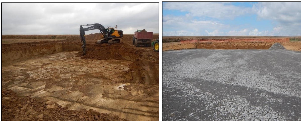
Figure 17 : Aire de montage au pied d'une éolienne (source : Luminus, parc éolien de Héron, 2016).
