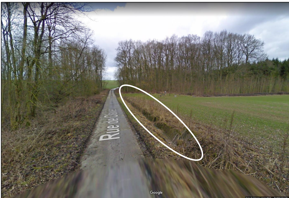
Figure 38 : Localisation du chenal en béton en "V" situé côté est du chemin vicinal n°58 entre les éoliennes n°5 et 6 (côté droit de la figure). La direction vers l'éoliennes n°7 est orientée en sens opposé de la figure. (Google streetview, mars 2010).
