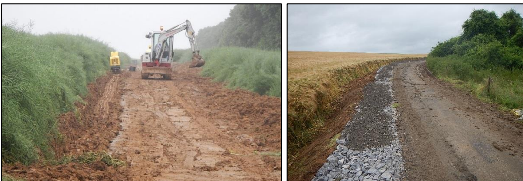
Figure 15 : Décapage du sol en vue de la création d'un nouveau chemin d'accès avec stockage des terres arables en merlons (photos : Luminus, parc éolien de Héron, 2016).
