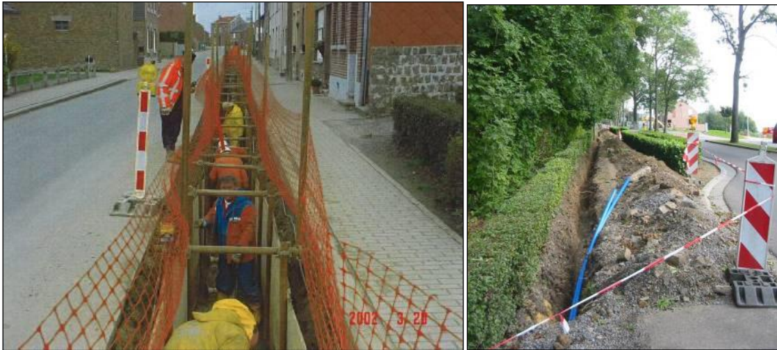
Figure 20 : Tranchées classiques en voirie (à gauche) et en accotements (à droite) (source : Elia, CSD).
